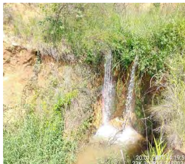
Foto 17 – Fluxo de água intenso para dentro da voçoroca.
