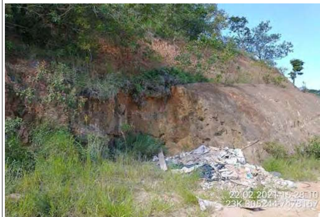
Foto 02 Feições erosivas ao longo do talude.
