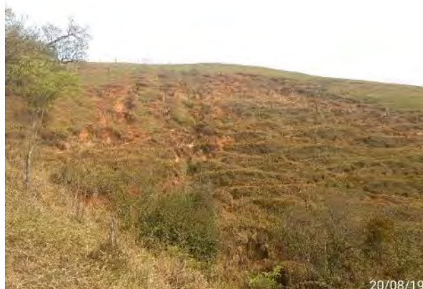
Foto 1 – Vista geral do processo erosivo.
