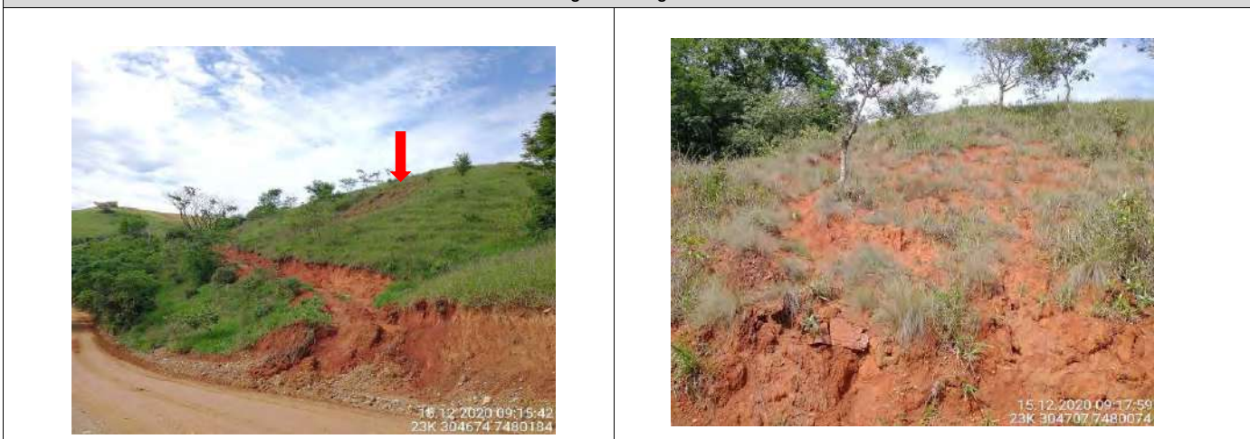
Foto 01 Vista geral das feições erosivas. Foto 02 Erosões em rastejo e no talude de corte.
