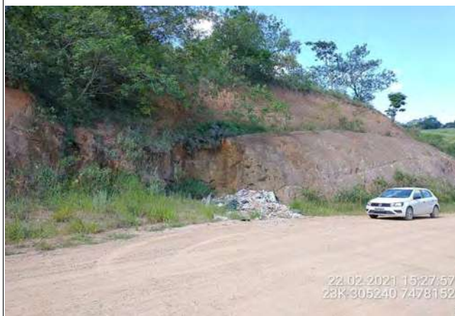
Foto 01 Vista geral das feições erosivas.
