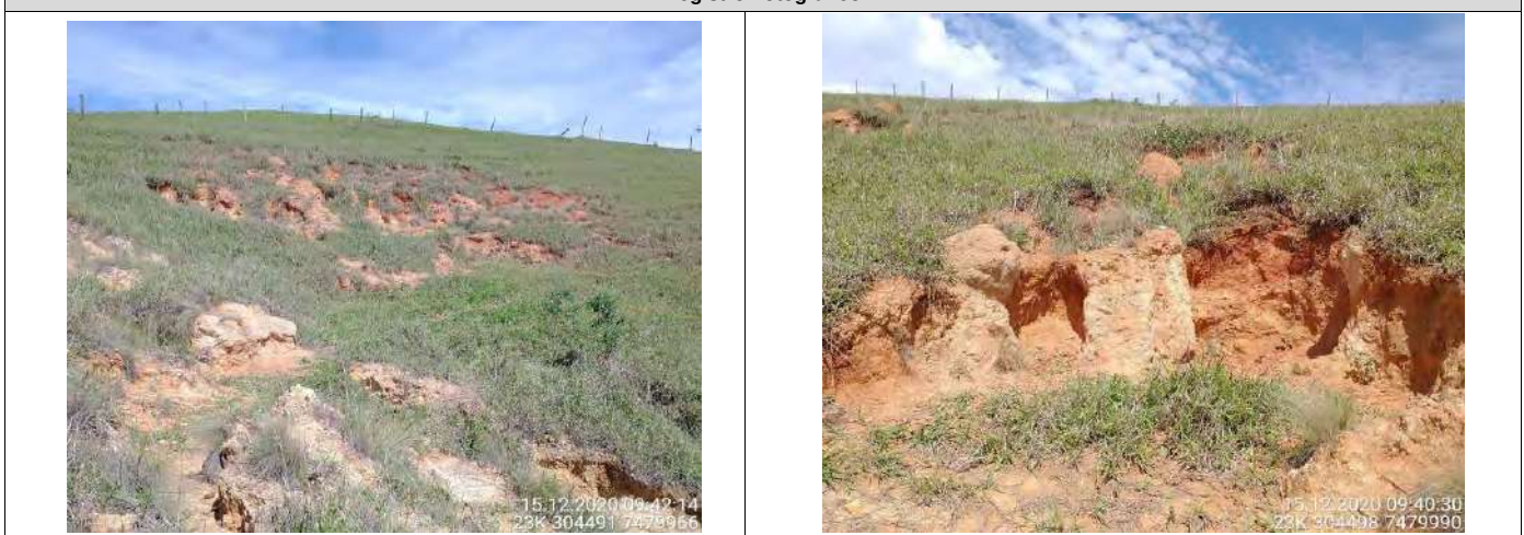
Foto 01 Processo erosivo no PA-03. Foto 02 Vista em detalhe do processo erosivo.
