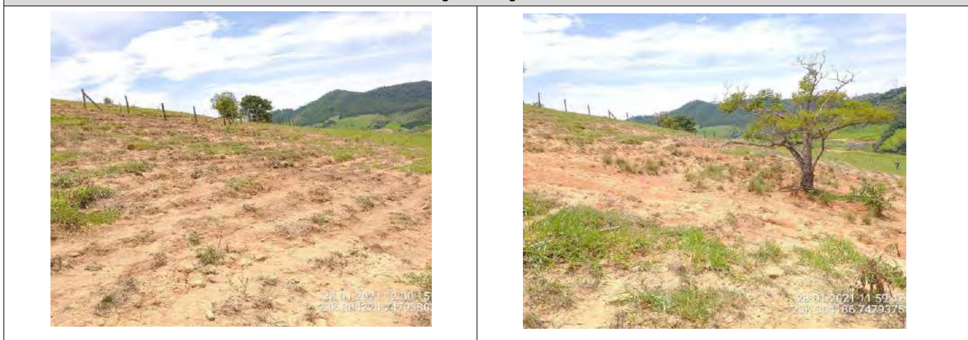
Foto 01 Vista geral das feições erosivas. Foto 02 Detalhe do processo erosivo.
