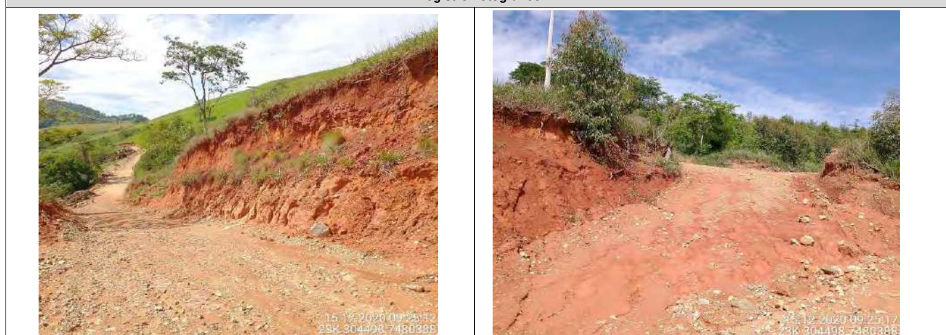
Foto 01 Processos erosivos no talude. Foto 02 Taludes de corte sob a influência de processo erosivo.
