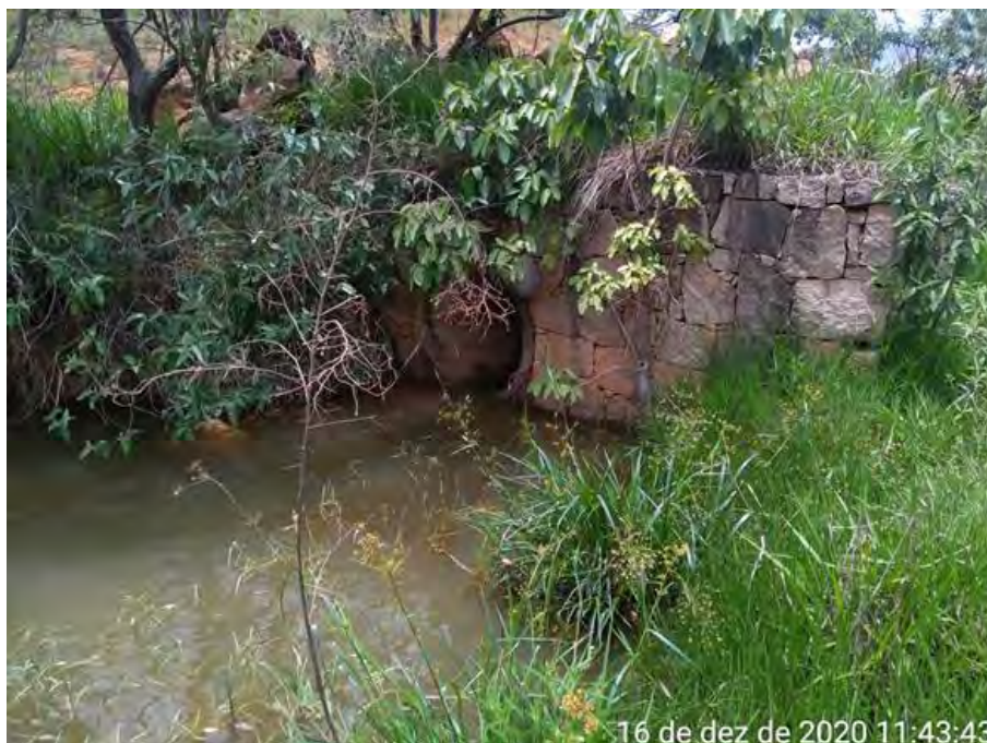
Foto 02: Ponto P07, na saída da barragem particular, vista da tubulação e do trecho a jusante.
