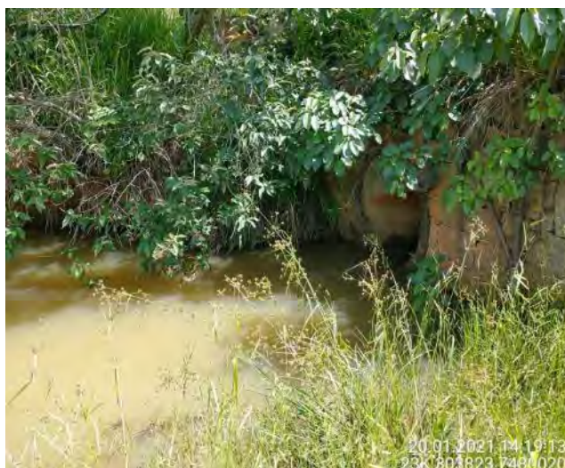
Foto 16 – Canalização de água da represa particular.
