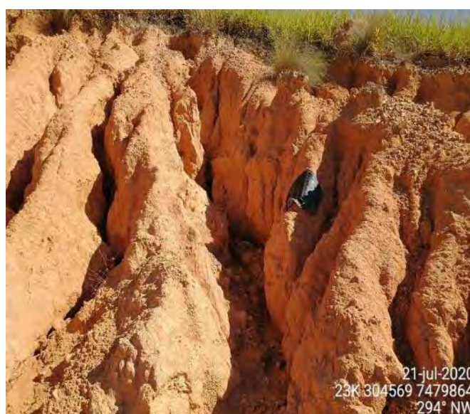
Foto 9 – Detalhe da dimensão das ravinas.
