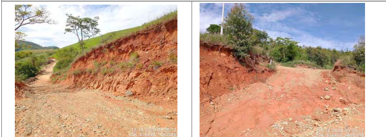
Foto 01 Processos erosivos no talude. Foto 02 Taludes de corte sob a influência de processo erosivo.
