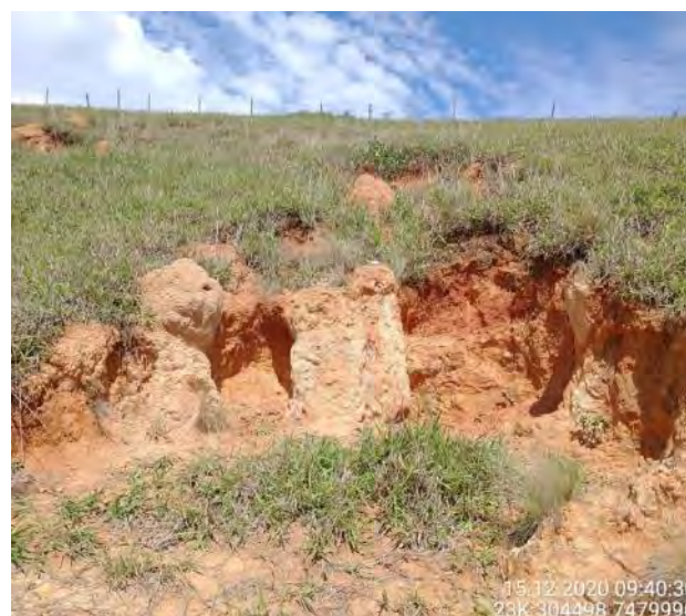
Foto 4 – Consequência do processo erosivo de creeping.
