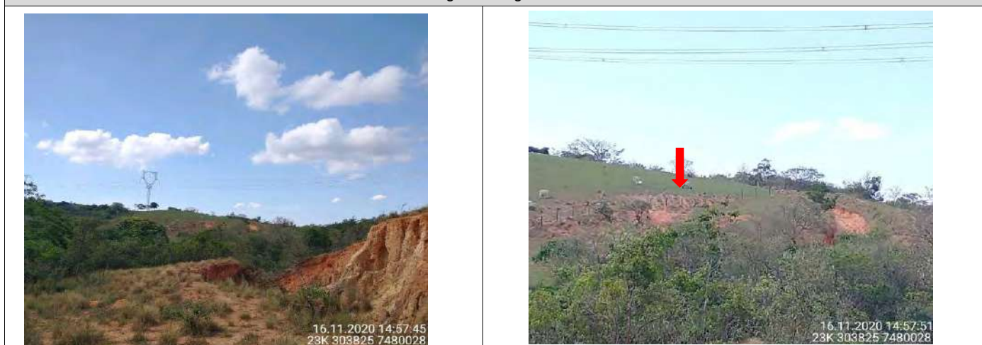
Foto 01 Vista geral do passivo ambiental Foto 02 Processo de ravinamento consequência da erosão superficial.
