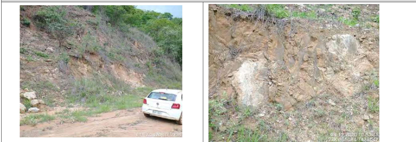
Foto 01 Vista das feições erosivas no talude. Foto 02 Detalhe do deslocamento rochoso.
